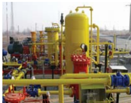
Vedere de ansamblu Instalația de compresoare Booster
