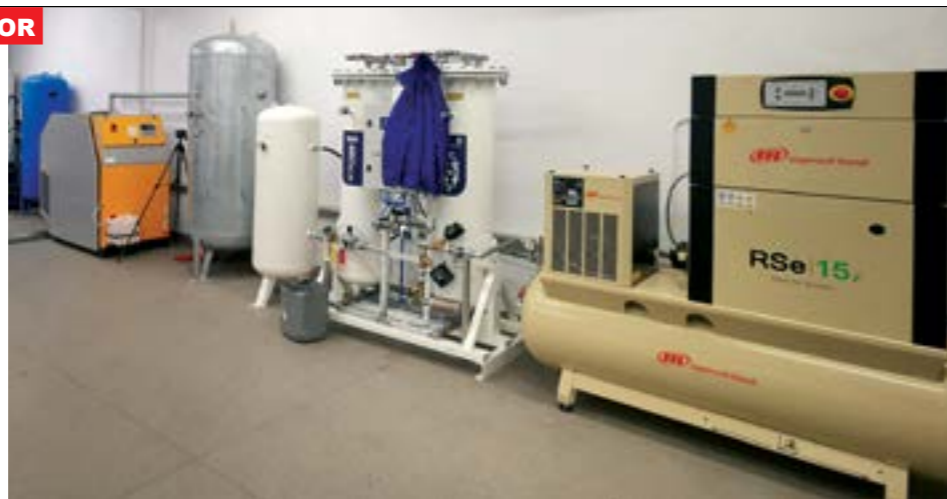
Instalația de producere azot de înaltă puritate și presiune
